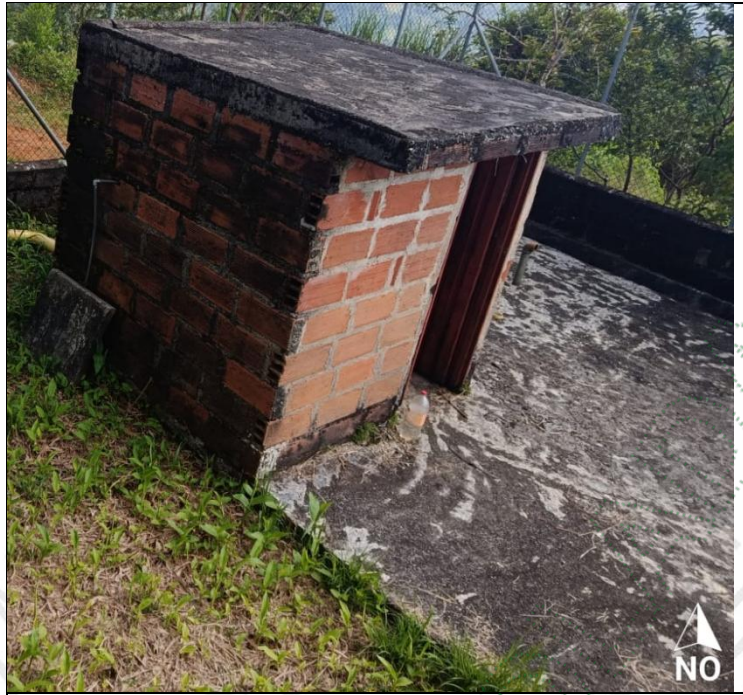
Imagen 6. Tanque de almacenamiento. Cornare 2026
