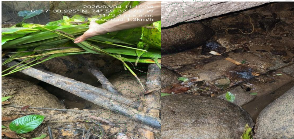
Imagen 1, 2. Bocatoma de los centros y los pomos. Fuente: Cornare, 2026
