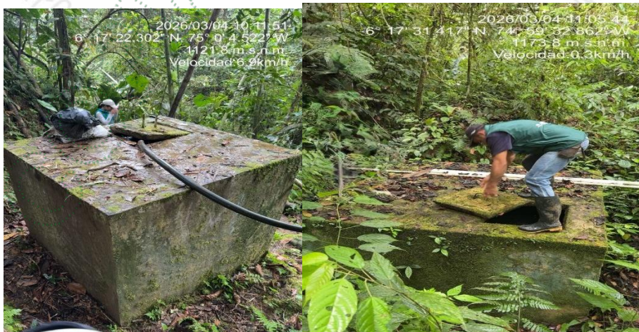
Imagen 3, 4. Tanques de almacenamiento de ambas fuentes. Fuente: Cornare, 2026
