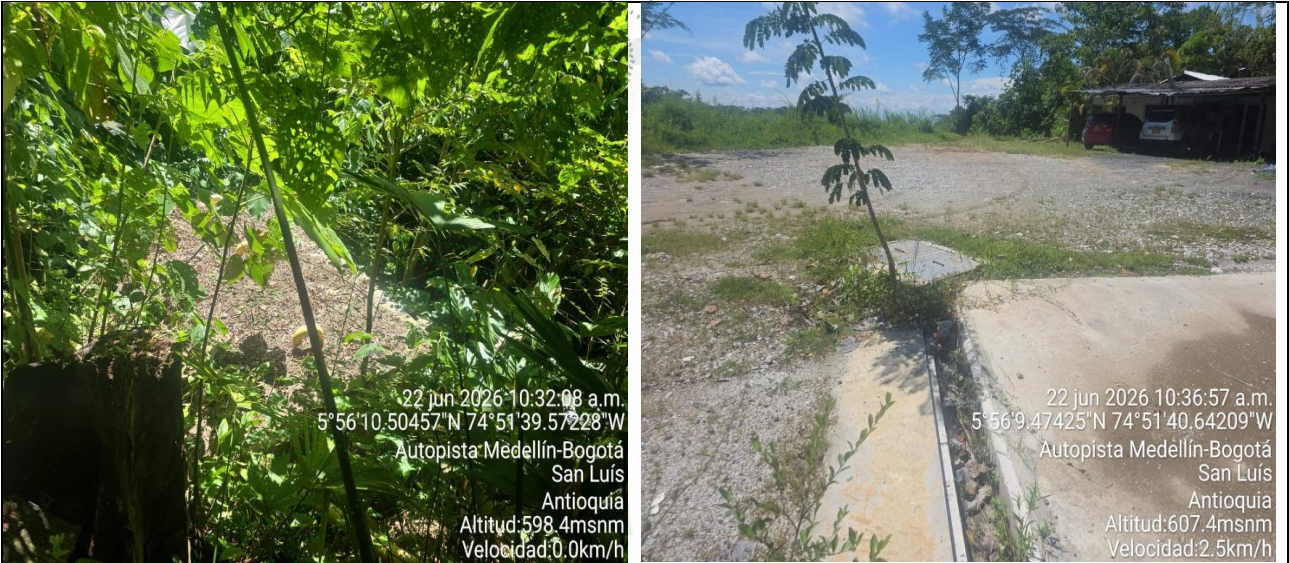
Imagen 9 y 10: Localización del pozo séptico y trampa de grasas
