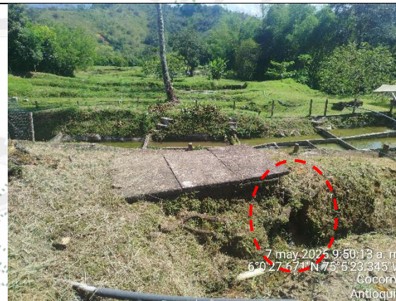
Figura 4. Tanque en mampostería donde se dirigen las ARD y la tubería de descarga a campo abierto
