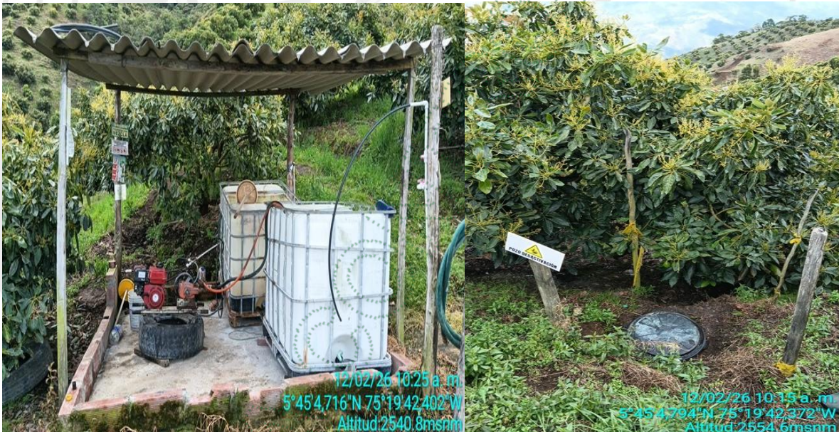
STARnD. Zona de preparación de mezclas y pozo de desactivación.
