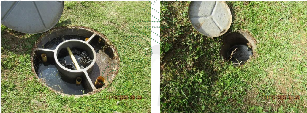
Fotografía 2. Rosetones y Caja de inspección de salida Fuente: EAV
