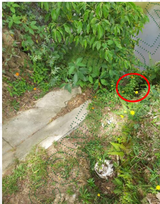
Fotografía 3. Descarga de ARD mediante tubería de PVC en el punto con coordenadas 75°19'2.181"W y 5°41'40.617"N.
