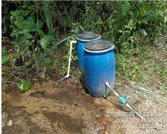
Obra de control de caudal
