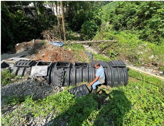
Figura 6. STARD instalado en el predio Depósitos de Estériles S.A.S.
