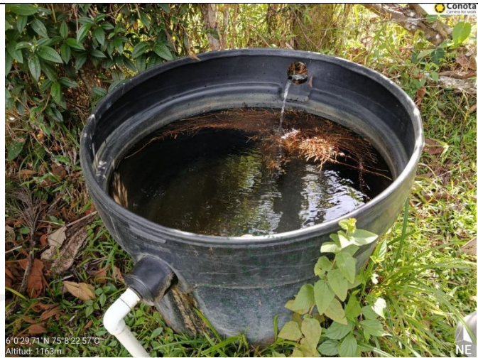
Imagen4. Tanque de almacenamiento. Cornare 2026
