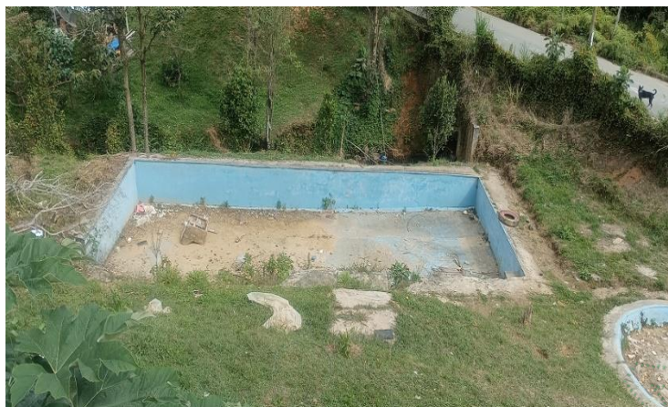
Piscina deteriorada y sin uso
