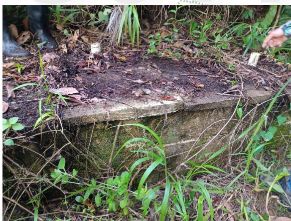
Figura 5. Sistema séptico en mampostería
