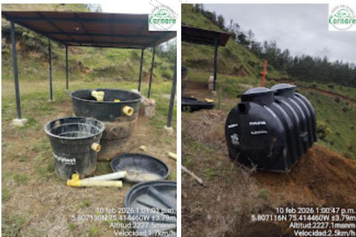
Componentes sin instalar
