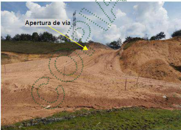
Figura 4. Proceso erosivo en zona media del predio
