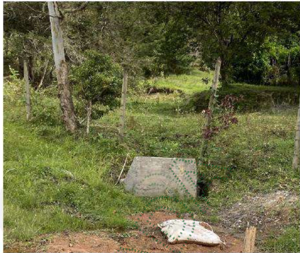
Figura 19. Caja de inspección zona suroeste.
