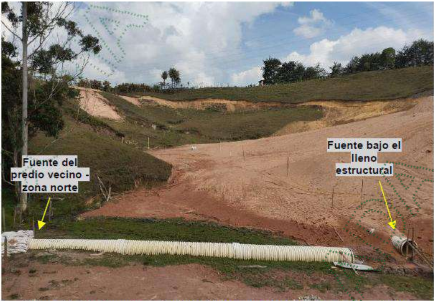
Figura 11. Confluencia de los flujos de agua conducidas a través de tuberías
