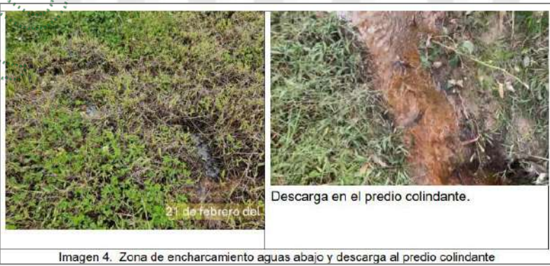
Figura 16. Encharcamientos en el lleno sobre la zona de recarga de la fuente hídrica
