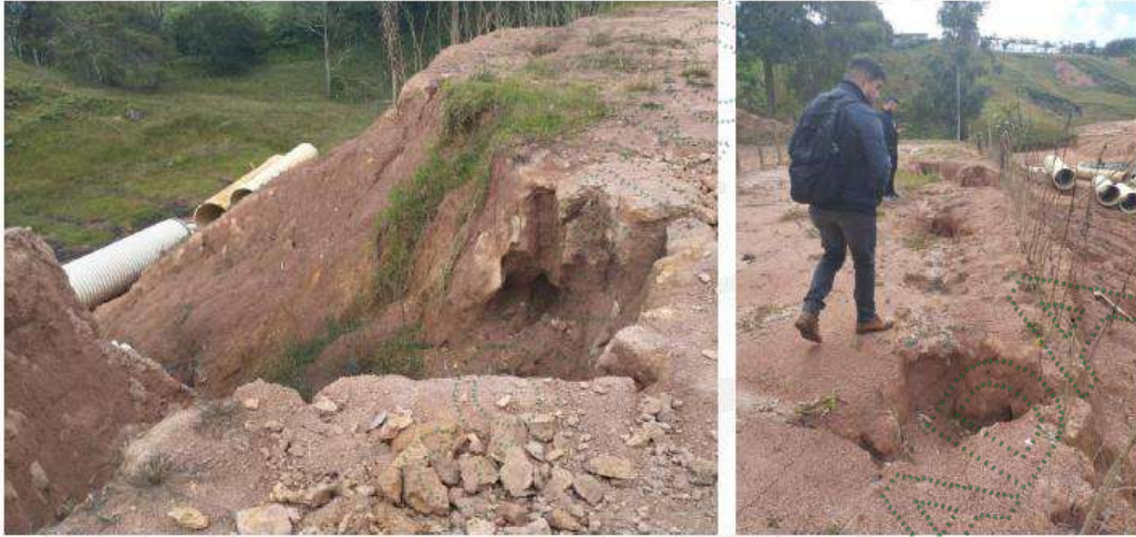
Figuras 5 y 6. Procesos erosivos en taludes del costado noroccidental del predio
