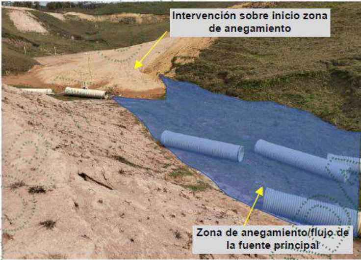
Figura 7. Ocupación sobre el inicio de la zona de anegamiento de la fuente principal tributaria a la quebrada La Palma.
