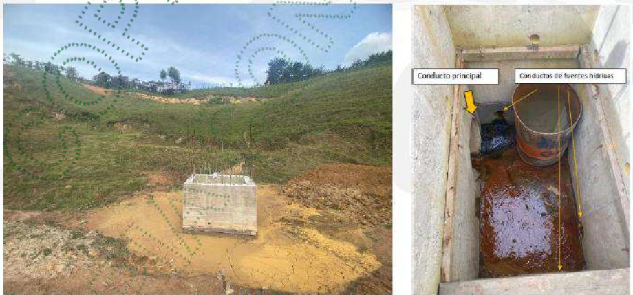
Figura 17. Caja de inspección zona norte.
