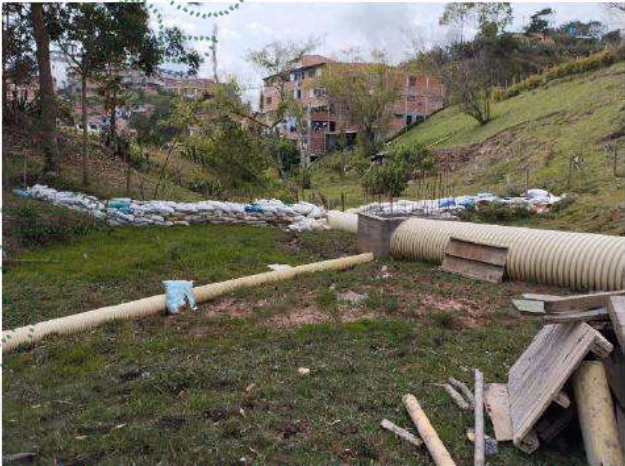
Figura 16. Disposición de tuberías, muro en costales y residuos en zona de anegamiento o encharcamiento de flujo de la fuente principal
