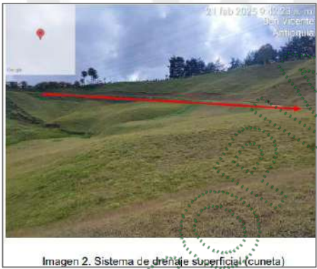
Figura 15. Cuneta implementada en zona oriental del predio
