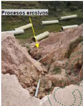
Figura 2. Proceso erosivo en la zona de ingreso al predio
