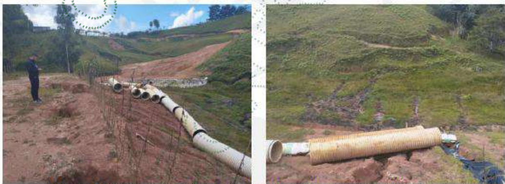
Figura 8 y 9. Tuberías localizadas en pata del lleno, el cual aún presenta procesos erosivos
