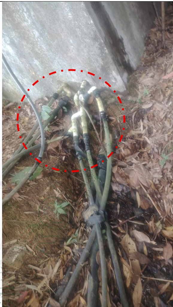
Imagen 8. Tanque de almacenamiento del Hotel y salidas de las tuberías de conducción.
