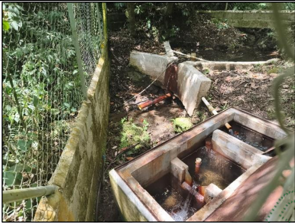
Figura 9. Captación de la fuente “El Roble Punto 2”
