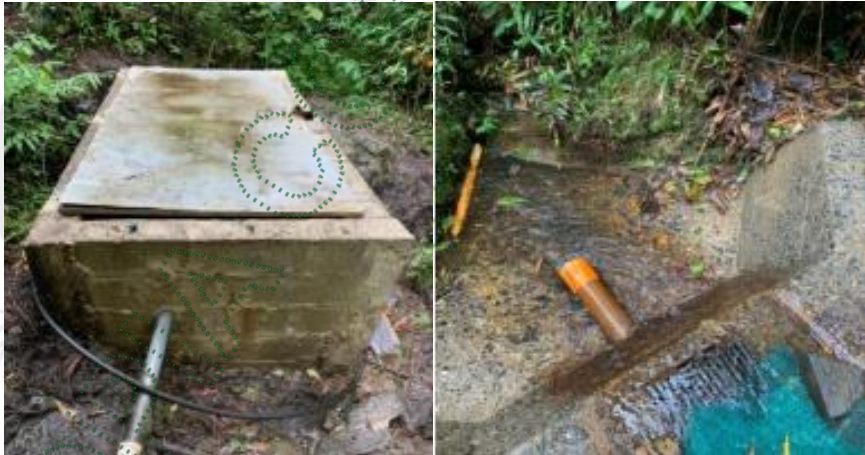
Figura 9. Captación de la fuente “Camargo”
