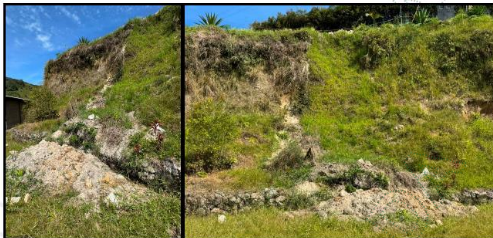
Imagen 2. Cornare. 2026. Desmoronamiento de talud cercano a la vivienda del lote 4 (derrumbe 2).
