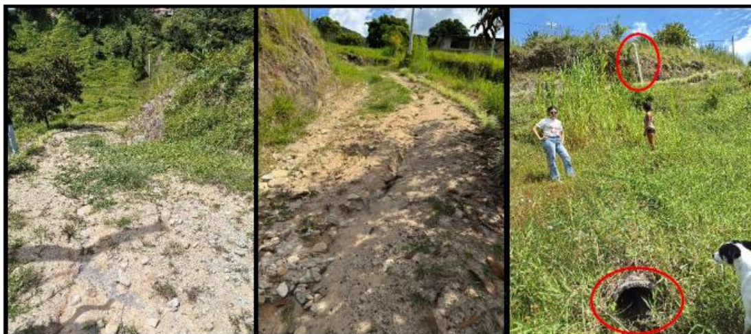
Imagen 4. Cornare. 2026. Estado de vía de acceso a los lotes 3 y 4; y tuberías que conducen el agua hacia el lote 3.
