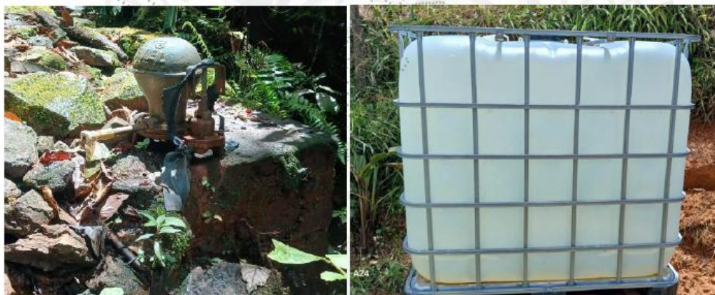
Imagen 6 y 7 ariete y tanque de almacenamiento del señor José Aníbal
