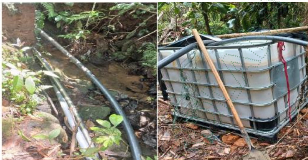
Imagen 4 y 5 mangueras y tanque de almacenamiento
