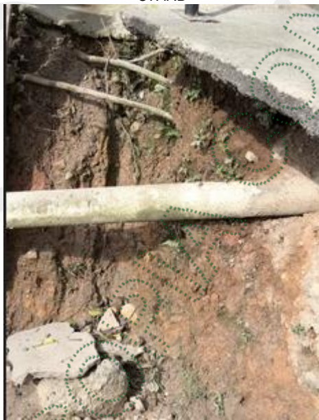
Tubería de salida
