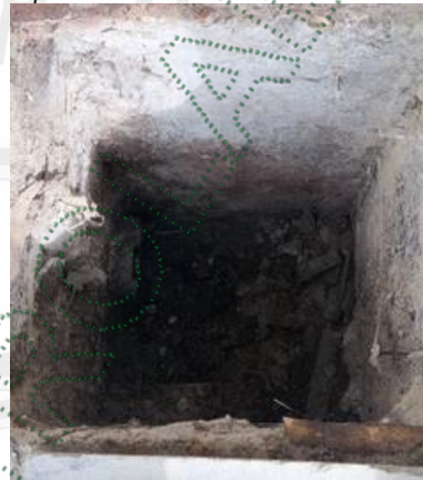
caja de inspección
