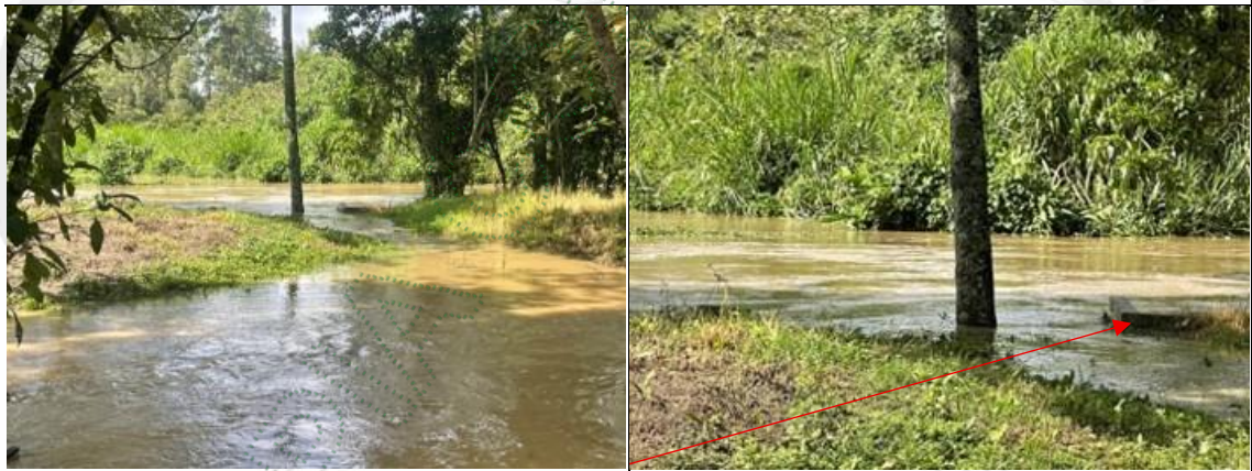
Obra de descarga tapada por inundación de la Quebrada La Cimarrona
