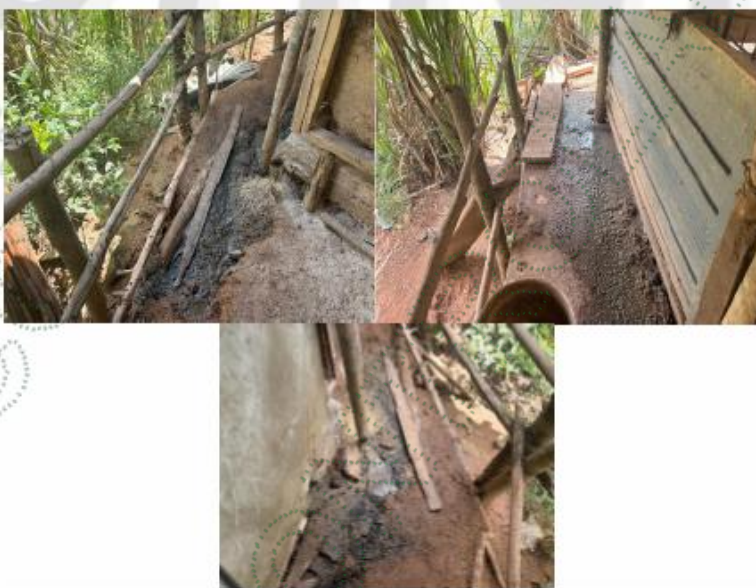
Imagen 2. Filtración y mala conducción de agua residual no doméstica.
