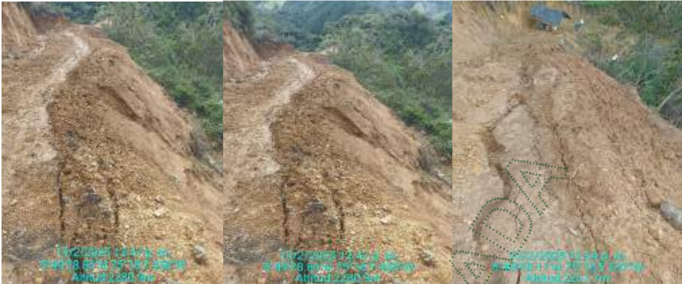
Agrietamiento del talud de relleno con riesgo de caer al Río Áures y la vía hacia La Unión.
