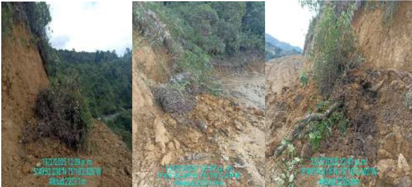
Varios deslizamientos presentados en el trayecto de la vía apertura
