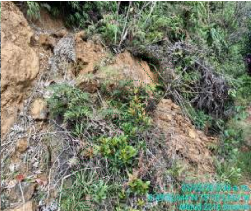
Febrero 2026 – Piedra que generaba alto riesgo en la vía
