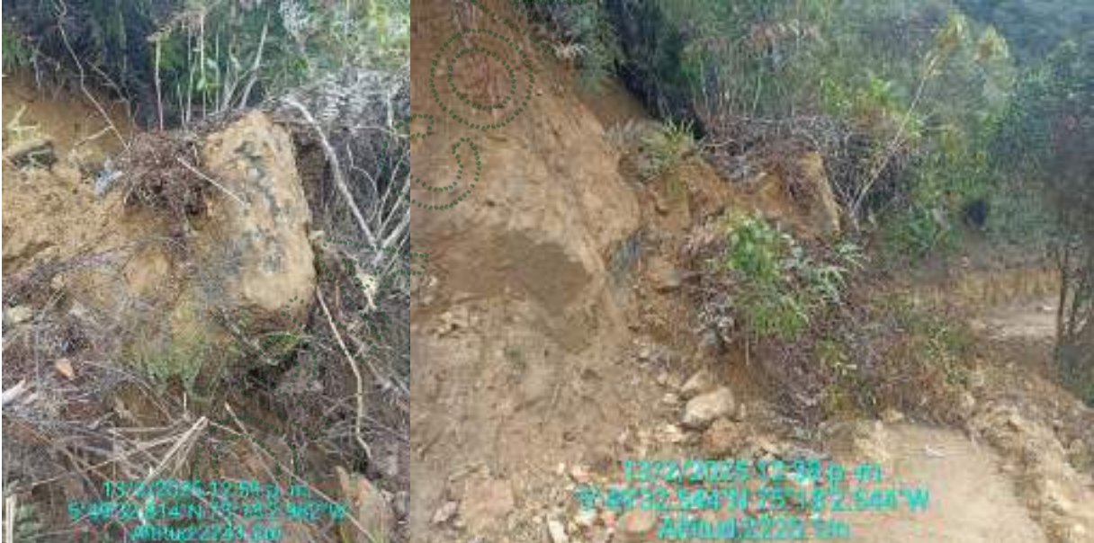
Roca desprendida del talud de corte con riesgo de caer a la vía principal.
