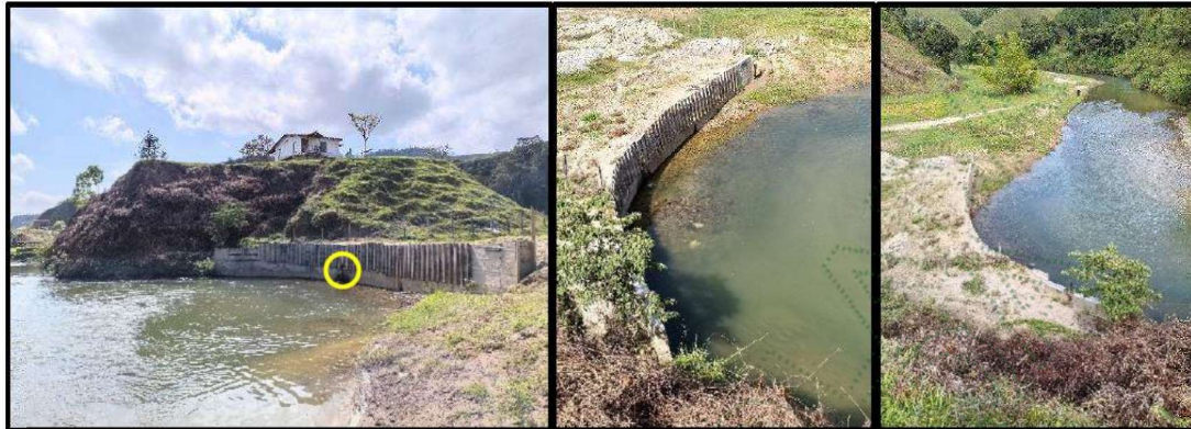
Imagen 1. Cornare. 2026. Muro de contención construido para protección y estabilidad de la colina baja donde se encuentra construida la propiedad.
