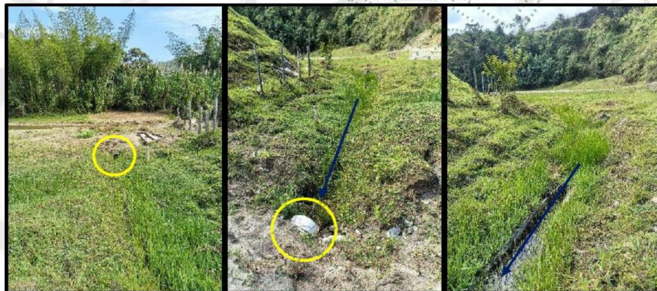
Imagen 2. Cornare. 2026. Ocupación del cauce e implementación de tubería sobre cauce de arroyo que transcurre por la propiedad de la señora Paula Zuluaga.
