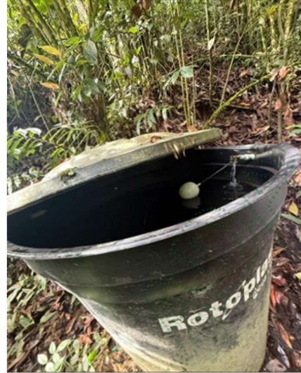
Tanque de Almacenamiento
