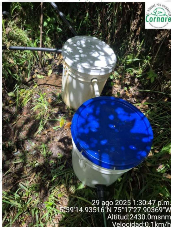
Imagen 1. Obra de captación y control de caudal
