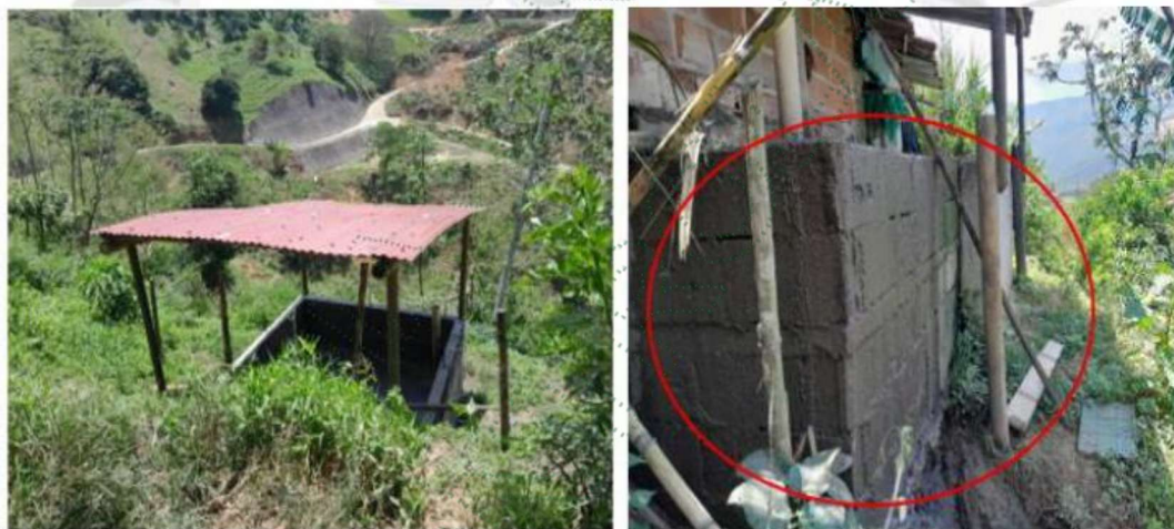
Imagen de los tanques estercoleros, donde se evidencia uno totalmente colapsado y con derrames al suelo.
