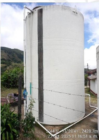
Imagen 11. Tanque de almacenamiento
