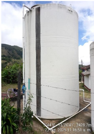
Imagen 3. Tanque de almacenamiento
