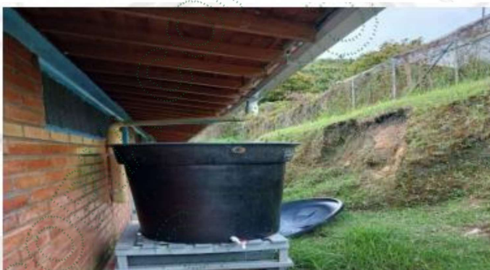
Tanque recolección de aguas lluvias
