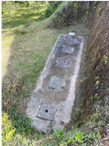
Planta de tratamiento de aguas residuales domésticas
