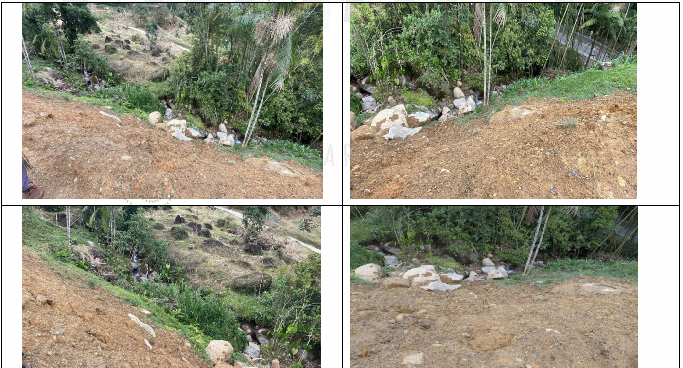
Fuente hídrica Sin Nombre con taludes expuestos, sin obras de control o retención para el material de arrastre
