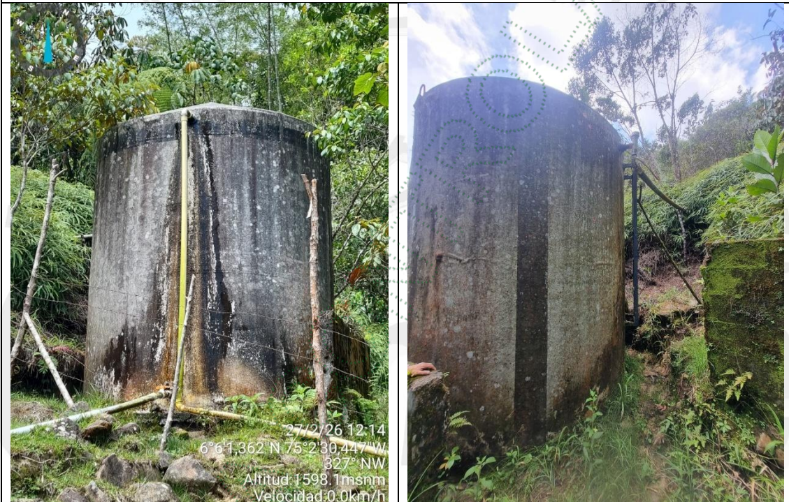
Foto 3 y 4. Tanque de almacenamiento ubicado en las coordenadas 06°06'1,35" N, -75°02' 30,45" W. Fuente: Cornare 2026.
