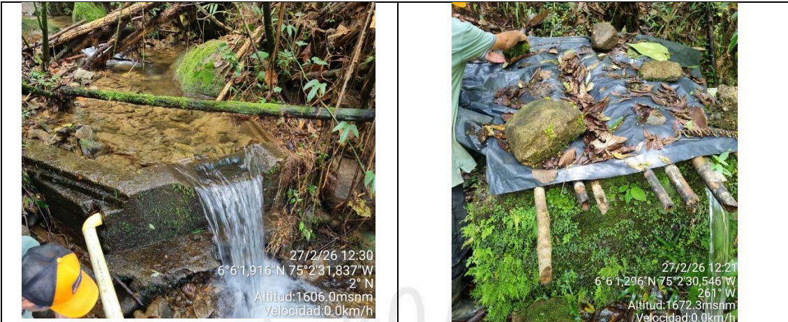
Foto 1 y 2. Sistema de captación y desarenador de la fuente denominada “Sin nombre” ubicada en las coordenadas 06°06'1,35" N, -75°02' 30,45" W. Fuente: Cornare 2026
