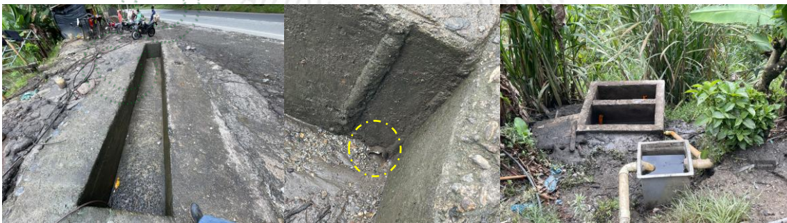
Figura 1. Guaje del Lavadero de carros La Milagrosa y sistema de trampa grasa y sedimentador implementado. Fuente Cornare 2026
