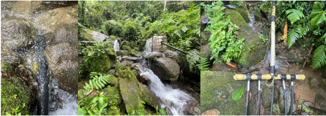
Figura 2. Punto de captación, tanque de almacenamiento y punto de distribución para el Lavadero de Carros La Milagrosa. Fuente Cornare 2026.
