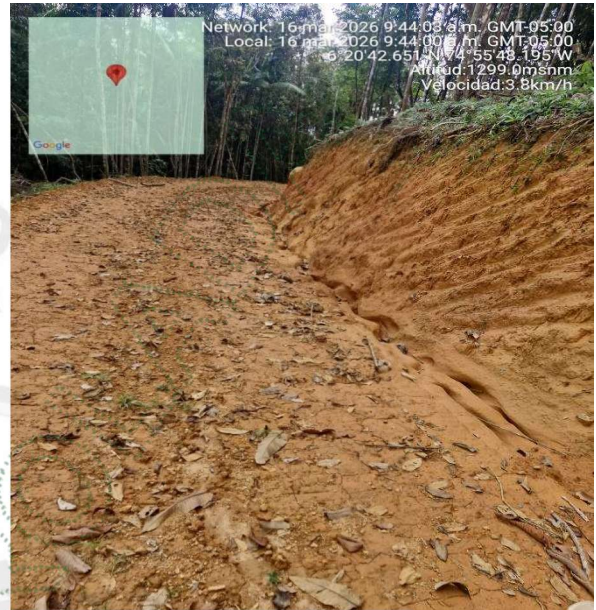
Imagen 8 presencia de cárcavas en la vía sin afirmar Comare 2026
