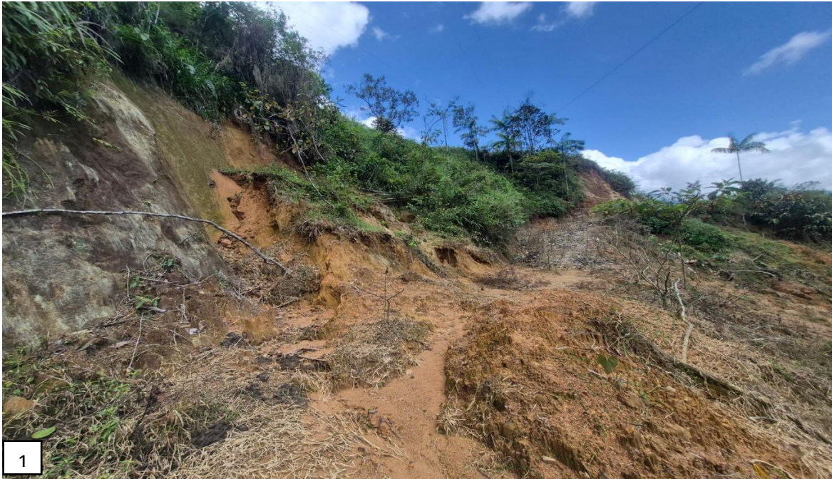
Imagen 1. Taludes con cobertura vegetal parcial, sin obras adecuadas de drenaje superficial.
