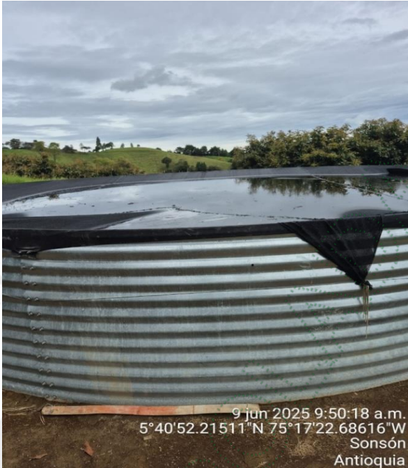
Imagen 6. Tanque de almacenamiento.
