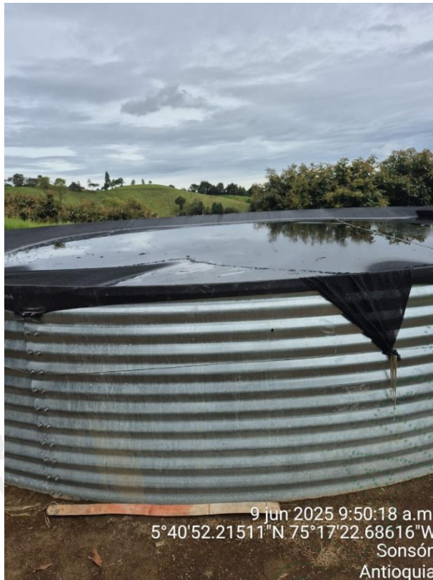
Imagen 3. Tanque de almacenamiento de 50mil litros.
