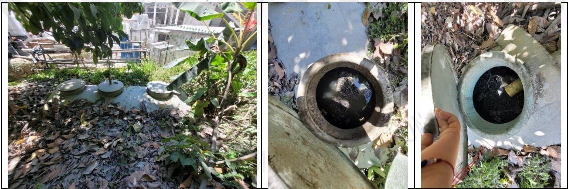
Imagen 27, 28 y 29. Sistema de tratamiento de aguas residuales domésticas - Empresa Rio Cal
