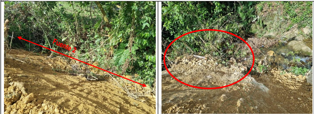
Foto 7 y 8. Material proveniente de la actividad de movimiento de tierras sedimentando fuente 2 Fuente: Cornare 2025.
