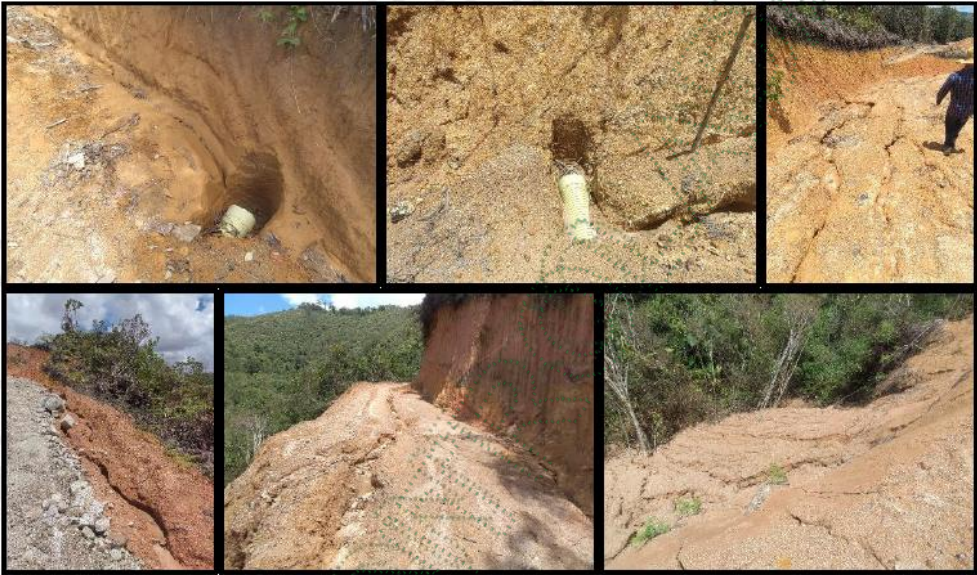
Imagen 3. Cornare. 2025. Medidas de drenaje y erosión del suelo por escorrentías.
