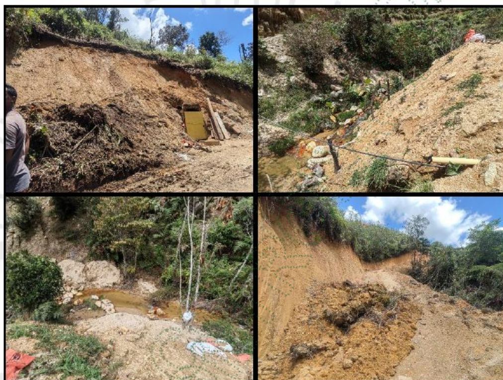
Imagen 2. Cornare. 2025. Taludes de la carretera en el tramo 1 y sedimentación de la fuente hídrica paralela.
