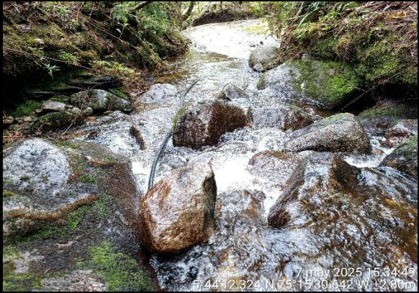
Captacion fuente hídrica Los Cañeros 2
