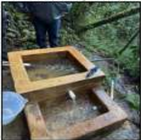
Imagen 8. Aranzalez, S.J. (2025). Obra de Captación # 3, El Retiro.
