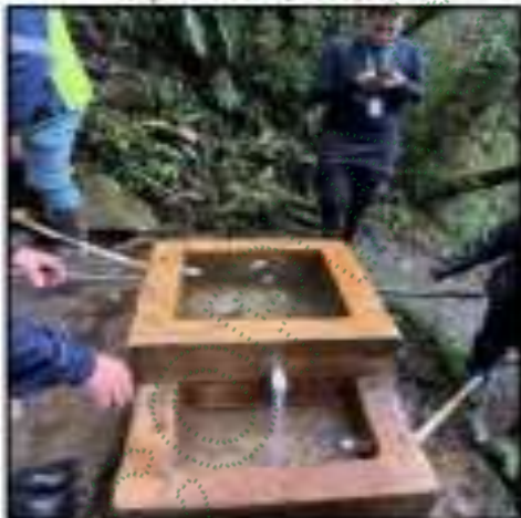
Imagen 7. Aranzalez, S.J. (2025). Obra de Captación # 3, El Retiro.
