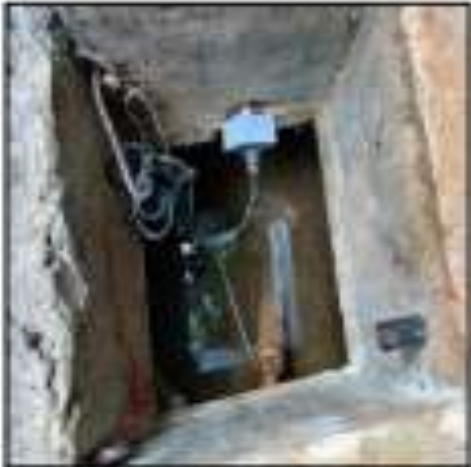
Imagen 3. Zapata, E.S. (2025). Tanque de Almacenamiento y Bombeo Obra de Captación # 1, El Retiro.
