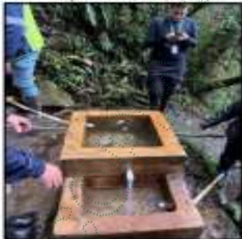
Imagen 7. Aranzalez, S.J. (2025). Obra de Captación # 3, El Retiro.
