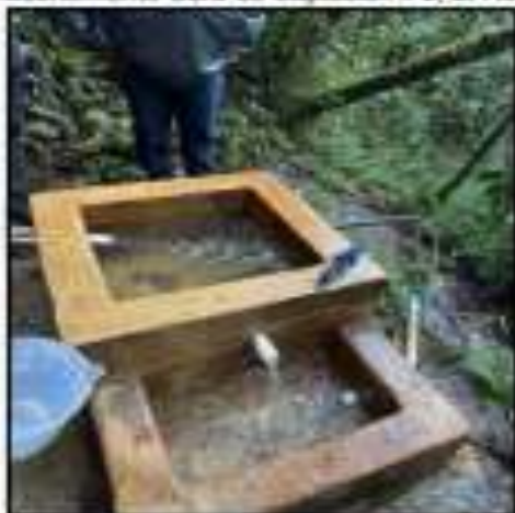
Imagen 8. Aranzalez, S.J. (2025). Obra de Captación # 3, El Retiro.
