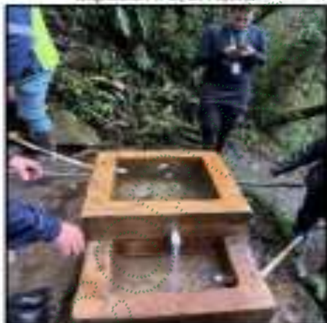
Imagen 7. Aranzalez, S.J. (2025). Obra de Captación # 3, El Retiro.
