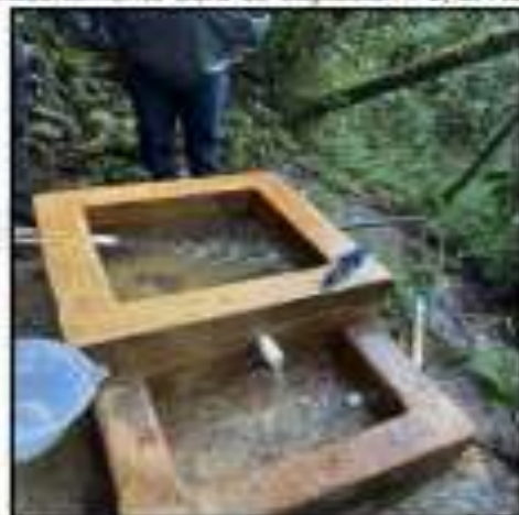
Imagen 8. Aranzalez, S.J. (2025). Obra de Captación # 3, El Retiro.
