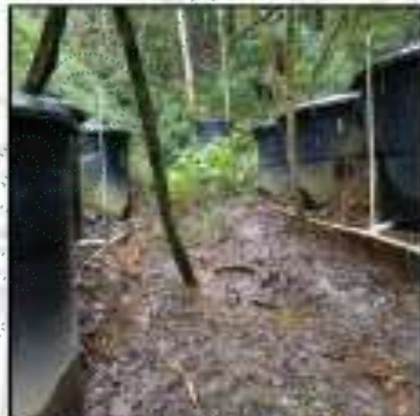
Imagen 6. Zapata, E.S. (2025). Tanques de Almacenamiento Obra de Captación # 2, El Retiro.
