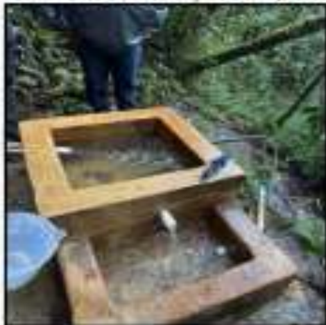
Imagen 8. Aranzalez, S.J. (2025). Obra de Captación # 3, El Retiro.
