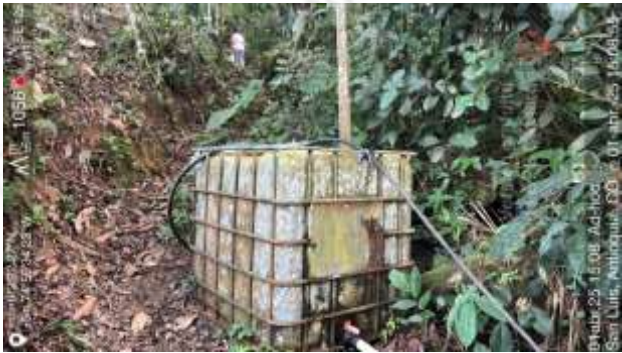
Foto 2. Tanque de distribución
