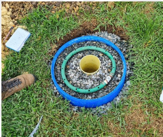
Campo de infiltración STARD Valesca
