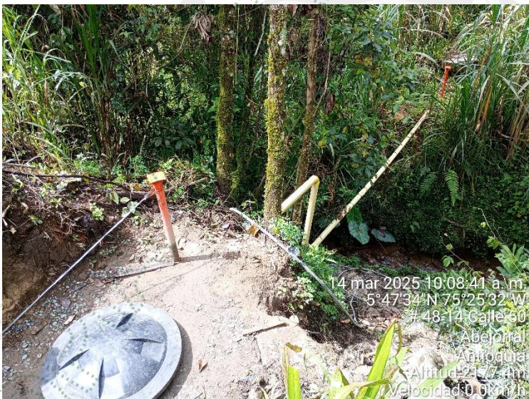
Conexión efluente a la red de alcantarillado municipal.
