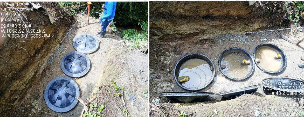
Sistema de pretratamiento antes de la descarga a la red de alcantarillado local
