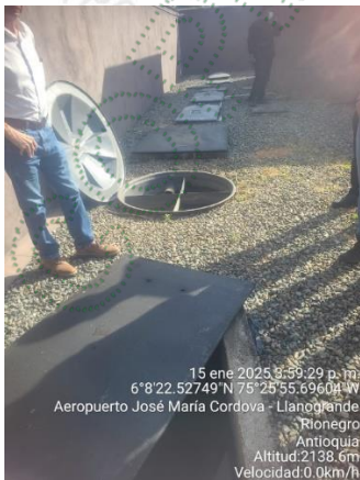
Fotografía 1. Sistema de tratamiento de aguas negras
