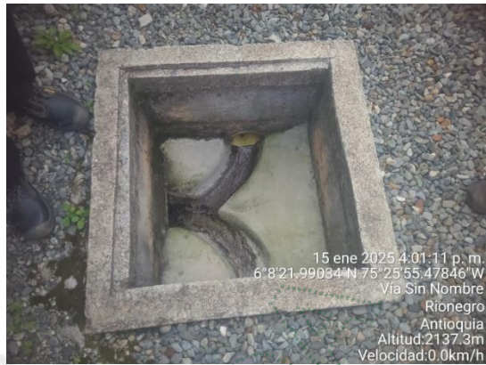
Fotografía 4. Caja de unión de aguas residuales negras y grises tratadas.
