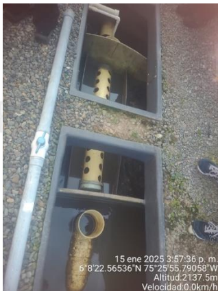
Fotografía 2. Sistema de tratamiento de aguas grises
