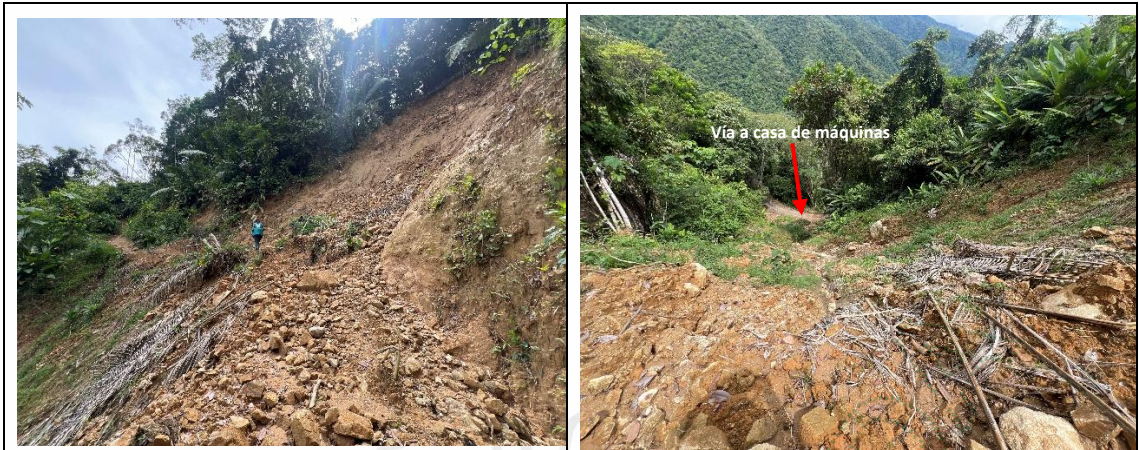
Imagen 11. Estado Deslizamiento 2, evidenciado en la visita técnica de control y seguimiento (25 de febrero de 2025)
