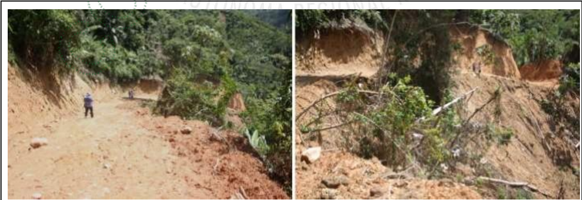
Imagen 10. Estado Deslizamiento 2, evidenciado en la visita técnica de atención a queja ambiental (14 de agosto de 2023)
