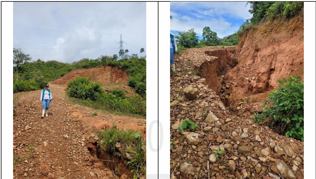
Imagen 18. Estado Nueva apertura de vía ubicada en predio identificado con FMI 018-109110, evidenciado en la visita técnica de control y seguimiento (25 de febrero de 2025)
