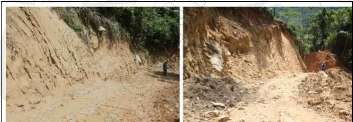
Imagen 12. Estado Surcos en los costados y desprendimientos del terreno de la vía sin permiso, evidenciado en la visita técnica de atención a queja ambiental (14 de agosto de 2023)
