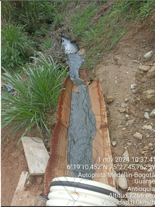
Ilustración N° 10. lamina de aluminio implementada como disipación en el descole de la tubería y encharcamiento de agua residual que fluye por la tubería
