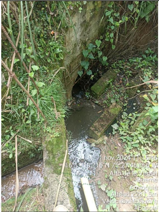
Ilustración N° 6. Estructuras de disipación en el encole de la tubería y aporte aguas de lluvia y escorrentía procedentes de las viviendas aledañas
